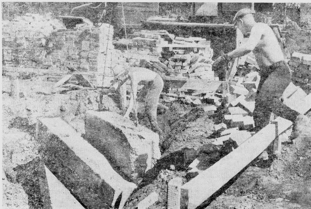
Монтируются первые блоки на строительстве больничного городка в Шушенском. Фото студента АДФ В. Тарасова.
